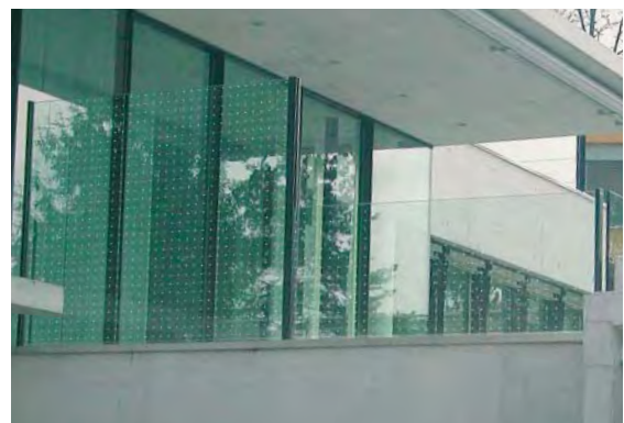
Gut gemeint, doch zu fein: An dieser Balkonverglasung mit sehr lückigem Punktraster kam es schon kurz nach der Montage zu den ersten Kollisionen.
