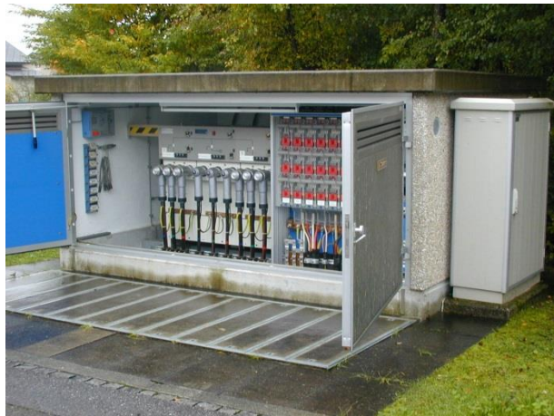
Trafostation „Im Staadacker Oensingen“ 1995, Foto AEK
